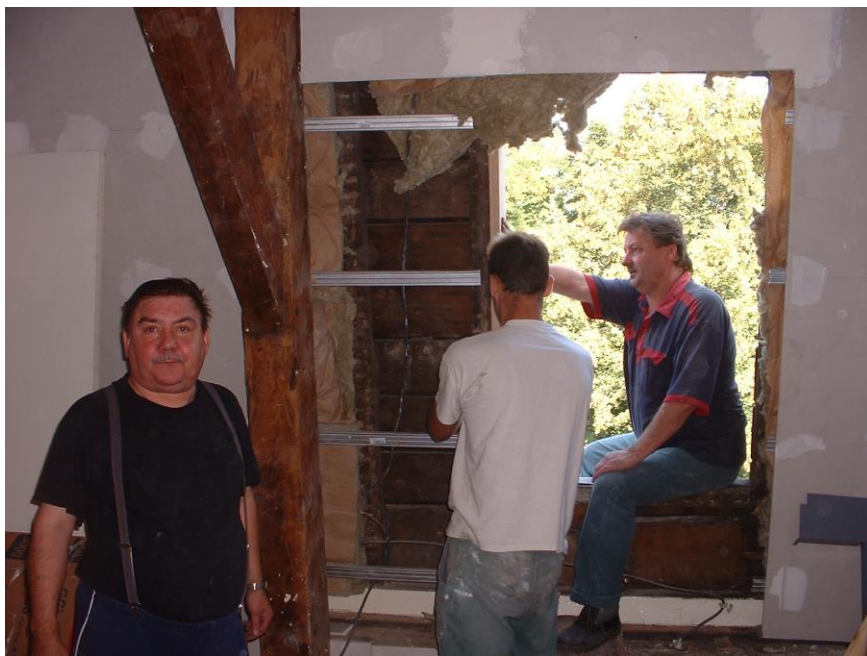
Le 19 août un ancien châssis va être remplacé par un velux, par 2 couvreurs et un plaquiste de l'entreprise METROPOLE CONSTRUCTIONS.
