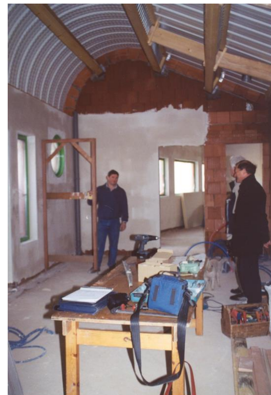
Pose des blocs portes par Bruno BOUTE , le 11 avril. Le plâtrier est parti le 5 et aura du mal à revenir.
