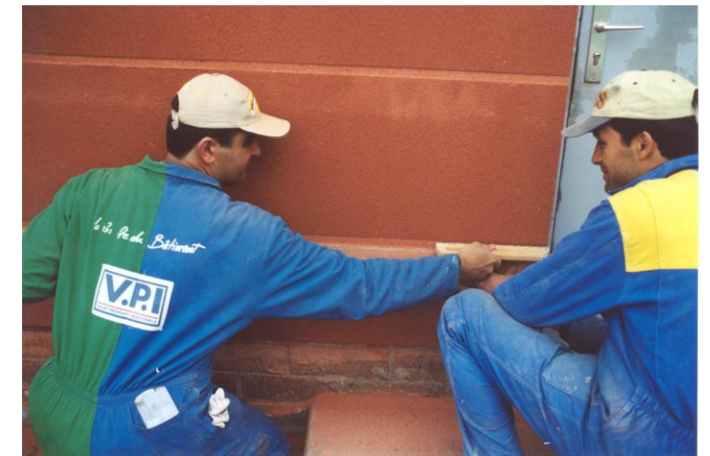
Tracé de la ligne, de niveau, en partant de l'axe des fenêtres circulaires, tous les 43 cm.
