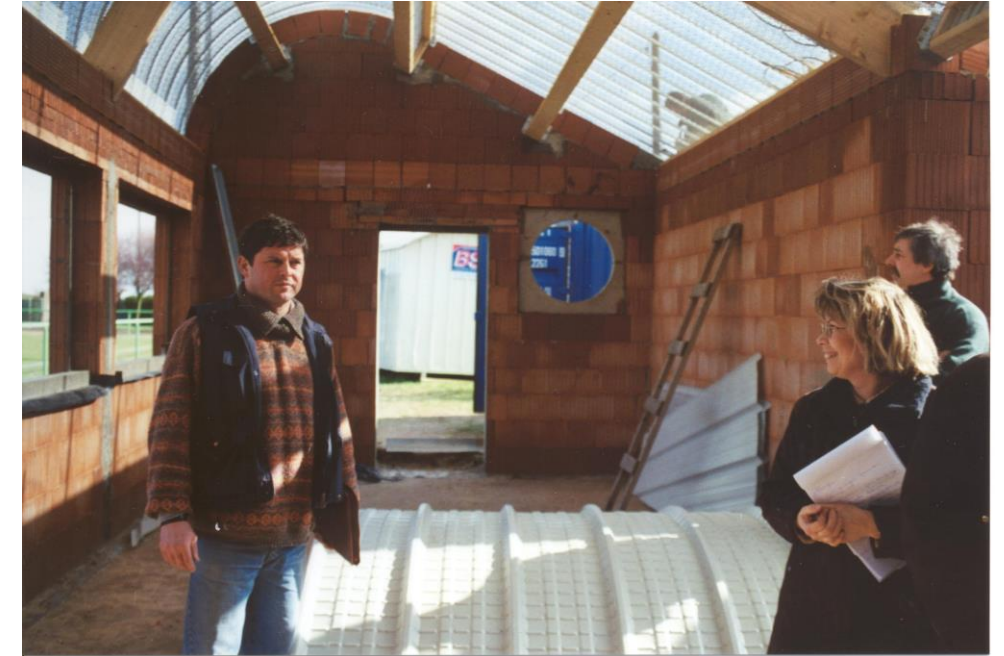
Réunion de chantier du jeudi 7 mars 2002 avec Mr BOUTE menuisier du service technique de la mairie et Mr ODAR, Mme DHAINAUT de l'entreprise BERCCQ, électricité Mr MARQUIS de France Telecom Mr DUFLOT, maître d'ouvrage et Mme CARRÉ Architecte DESL.
