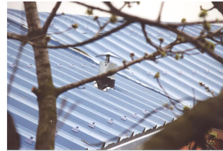
Sortie en toiture de l'extraction de la VMC. 21.03.02
