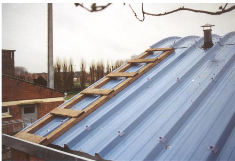
Sortie en toiture de la ventilation primaire des douches.
